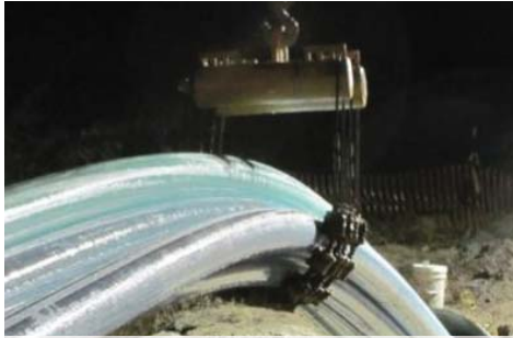
National Grid Malden, MA
